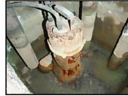
ポンプの劣化
