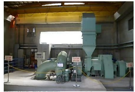
大志田ダム発電所 (管理主体：馬淵川沿岸土地改良区、最大出力 810kW)
