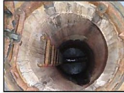
マンホールコンクリートの劣化
