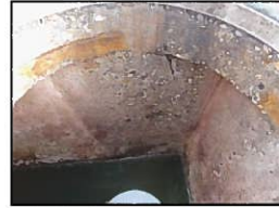
水槽内コンクリートの劣化
