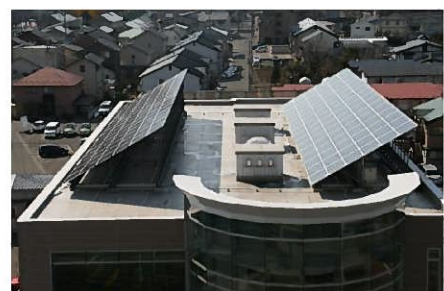
水土里ネットいわて発電所 (管理主体：水土里ネットいわて、最大出力 47.5kW)
