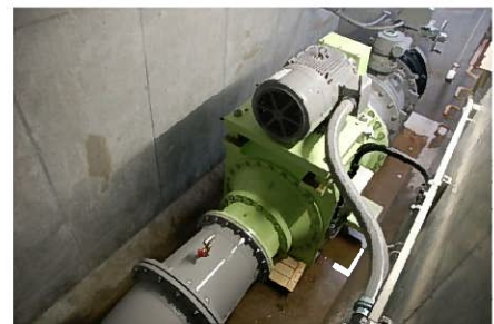
照井発電所 (管理主体：照井土地改良区、最大出力 50kW)
