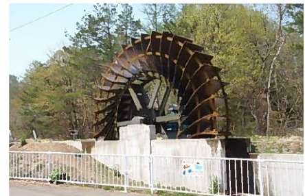
明治百年記念公園発電所 (管理主体：八幡平市、最大出力 9.9kW)
