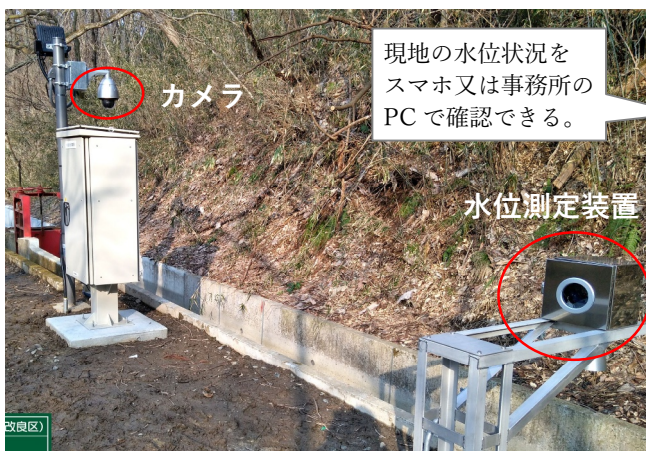
【水位測定装置・カメラの設置による水位の遠隔監視】
