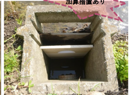
排水の流量調整による水田の雨水貯留機能の強化（田んぼダム）
