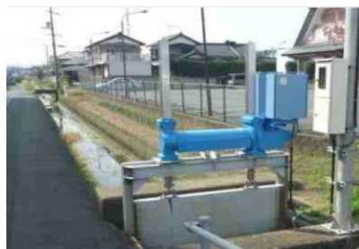
〔樋門開閉機の電動化〕
