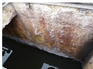
水槽内コンクリートの劣化
