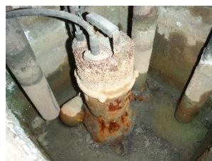
ポンプの劣化
