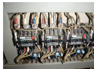
制御盤内の配線の劣化
