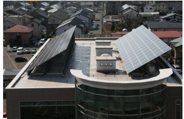
水土里ネットいわて発電所
