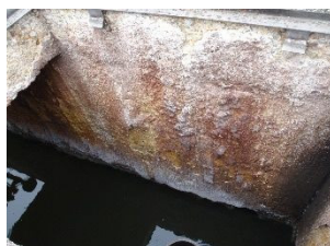
水槽内コンクリートの劣化
