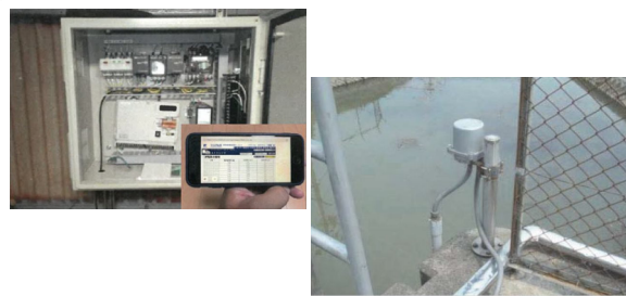
〔監視装置や水位計の設置〕
