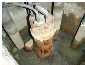
ポンプの劣化
