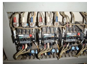
制御盤内の配線の劣化
