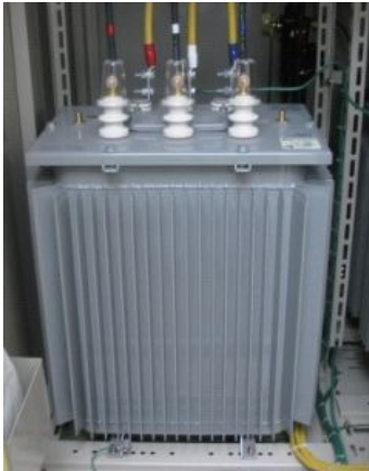
高効率変圧器
