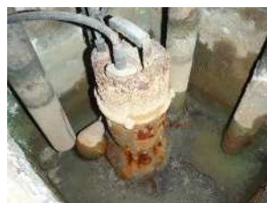
ポンプの劣化
