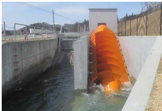
八幡沢発電所 (管理主体：照井土地改良区、最大出力 19.9 kW)
