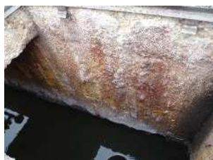
水槽内コンクリートの劣化
