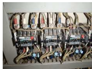
制御盤内の配線の劣化
