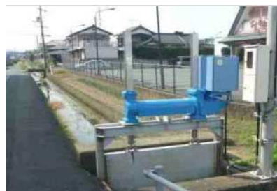
〔樋門開閉機の電動化〕
