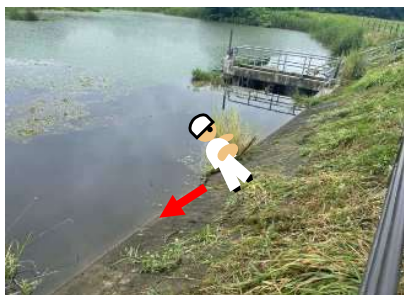
(ため池堤体の急傾斜)
