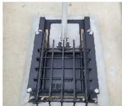
斜樋（スライドゲート）
