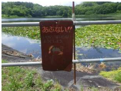
写真43：看板の劣化、破損
