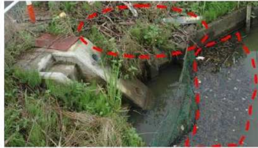
写真 38：取水部周辺の土砂やゴミの堆積
